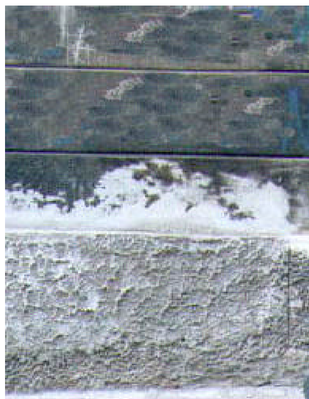
Zoccolatura in intonaco di circa cm 60 di altezza, con finitura a rustico ad imitazione della pietra.
