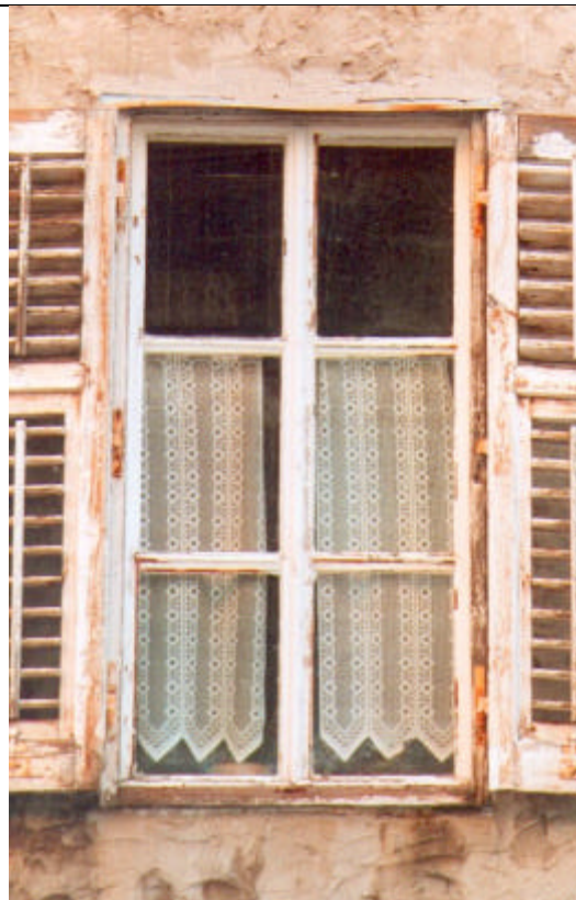
Infisso in legno verniciato a due ante apribili verso l'interno. Ciascuna anta è suddivisa in tre parti vetrate fisse. Il telaio fisso della finestra costituisce anche l'alloggiamento per le ante della persiana.
