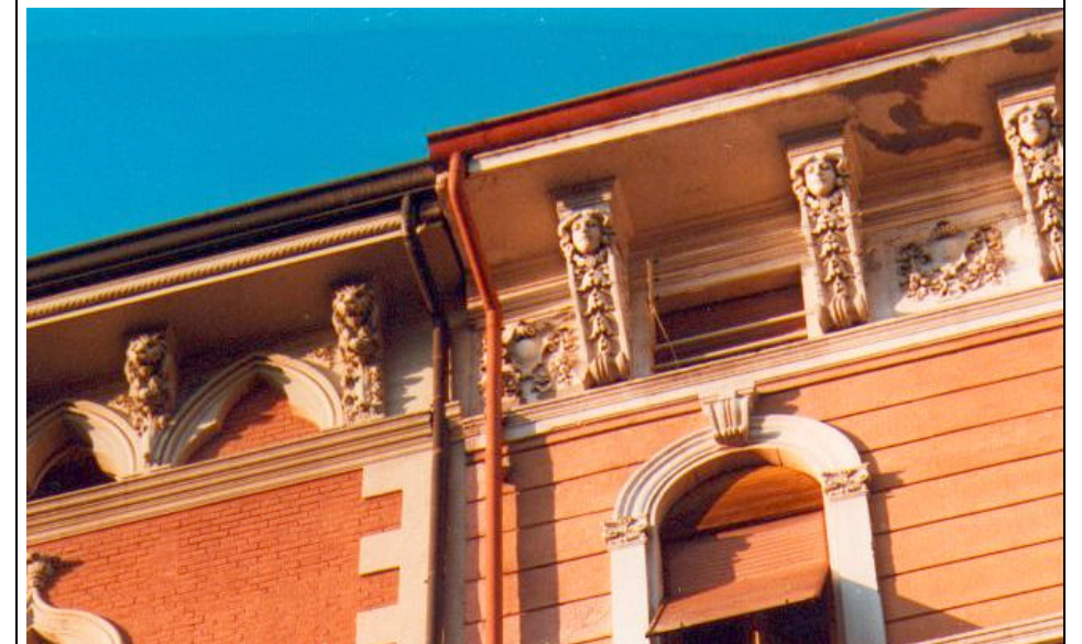
Cornicioni con spioventi semplicemente modanati e sostenuti da modiglioni con fasce sottocornice riccamente decorati secondo lo stile "eclettico".
