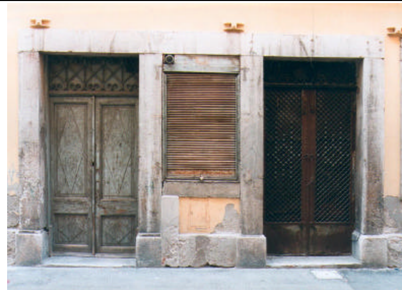
Cornice rettilinea in pietra che riquadra tre aperture affiancate con stipiti centrali comuni ed architrave continuo realizzato con tre elementi lapidei. I piedritti hanno gli elementi di base sporgenti raccordati alla zoccolatura. Il portoncino è in legno verniciato a due ante con specchiature decorate a rombo e sopra luce rettangolare protetto da inferriata.
