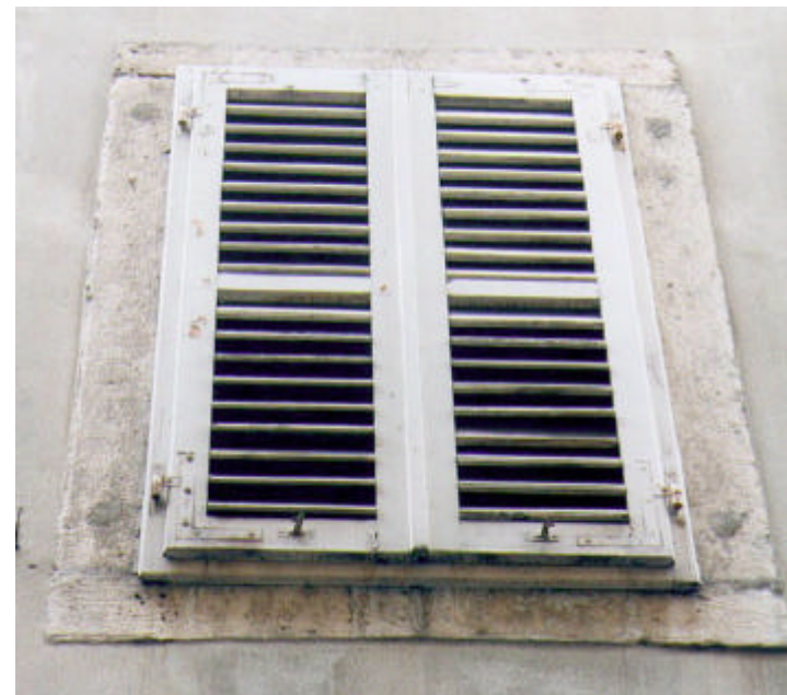
Cornice costituita da quattro elementi di pietra naturale a piani lisci.
