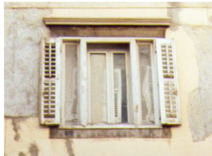
Infisso tripartito con due battenti centrali e due ante apribili laterali. I battenti centrali sono stati sostituiti con profilati in alluminio preverniciato.
