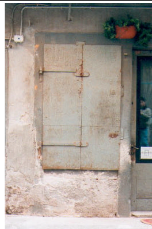
Portellone in ferro a due battenti con due bandelle per la sola anta sinistro.
